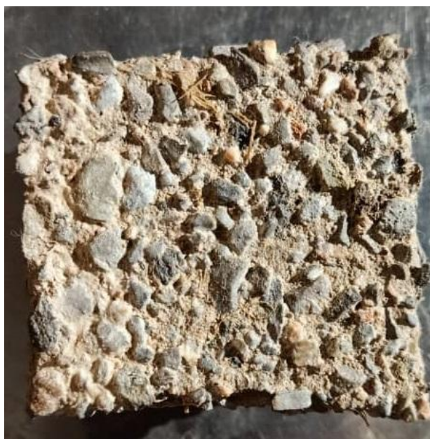
FIGURE 8. Détérioration des textures superficielles.
