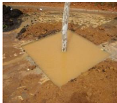
Photo 5 : Plombage à l'eau (Ben Aknoun)
