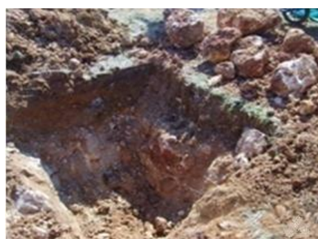
Photo 9 : Potet superficiel sur dalle
