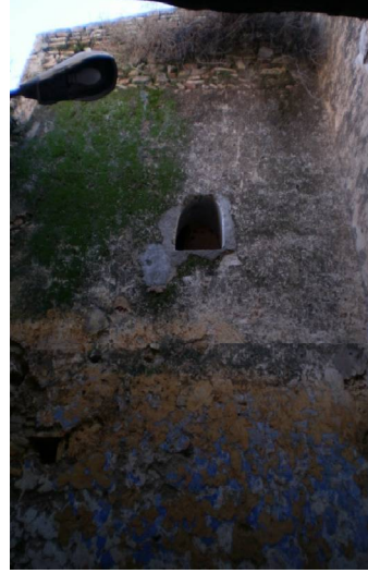
مسلك نافذ بدرب السلسلة، نلاحظ سقوط الملاط، ونمو الحشائش بالأعلى، ووجود الطحالب، مما سيؤثر سلبا على الجدران.
