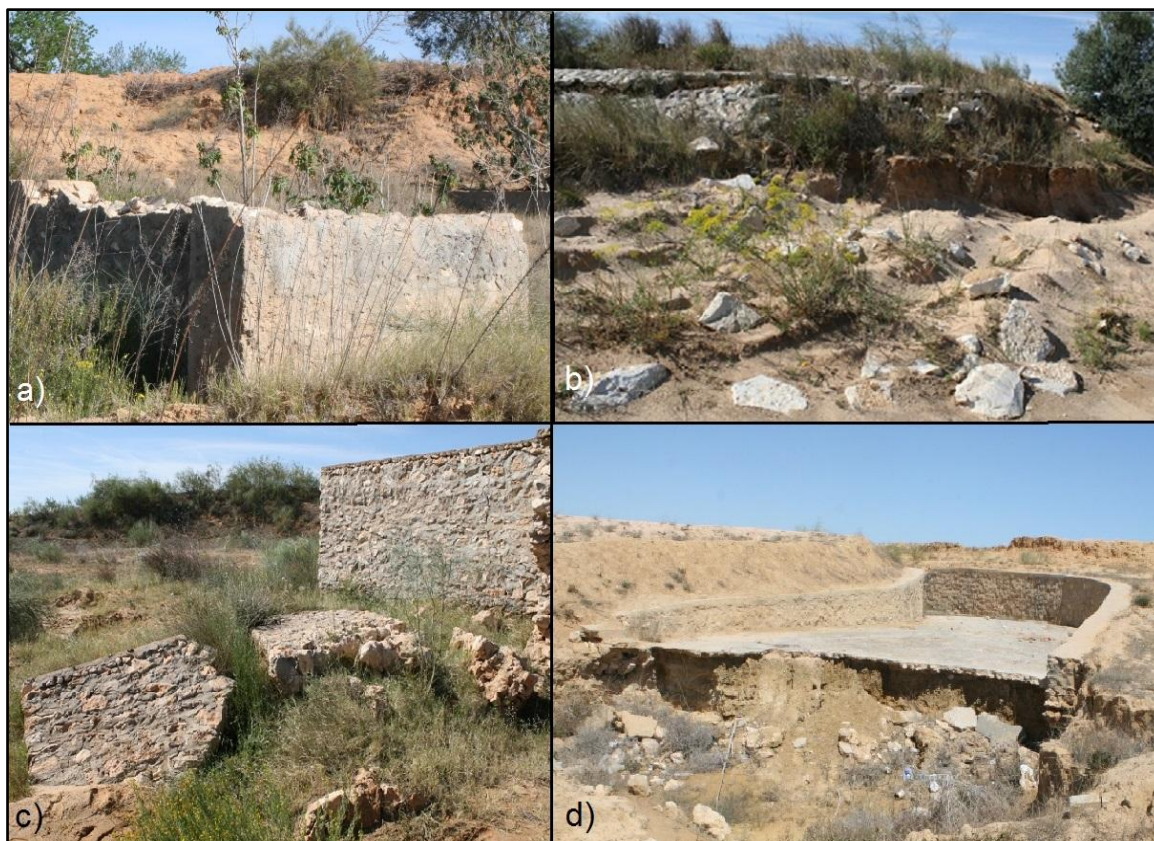
Figure 6.- Exemples d'ouvrages anti-érosifs dégradés (a : épis, b : ouvrage en pierre, c : seuil et d : évacuateur de crue)
