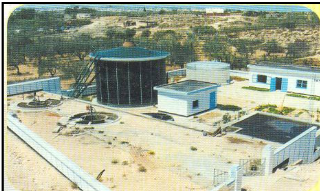
Photo 1.- Vue générale de l'installation de biométhanisation industrielle avicole étudiée
