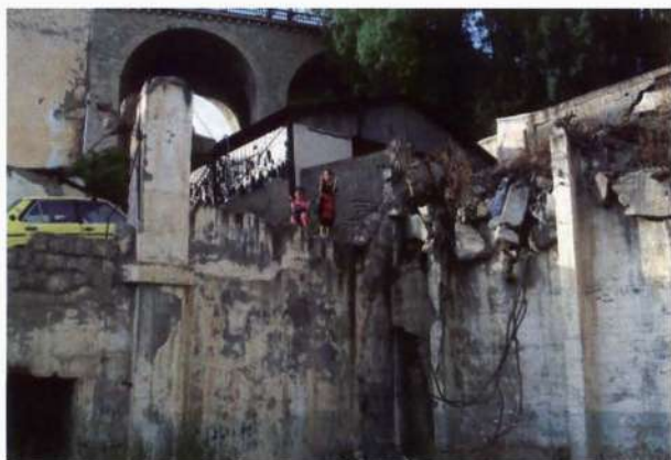
Photo 4 - Constructions fissurées et abandonnées, sur le talus aval du pont.
