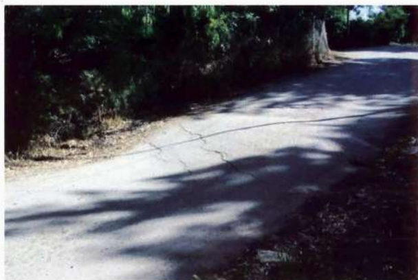
Photo 6 - Affaissement et fissuration d'un chemin forestier, en amont du pont
