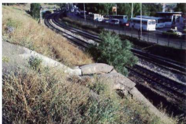
Photo 7 - Déformation et fissuration de tous les ouvrages de drainage des eaux superficielles, talus amont de la plate-forme ferroviaire.
