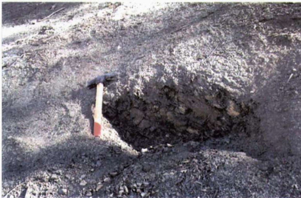
Photo 3 - Marnes schisteuses, très altérées et fissurées du complexe tellien allochtone, Talus de la gare ferroviaire Schisteous marls, very weathered and fissurated of allochtoneous tellian formation, Rail way station slope
