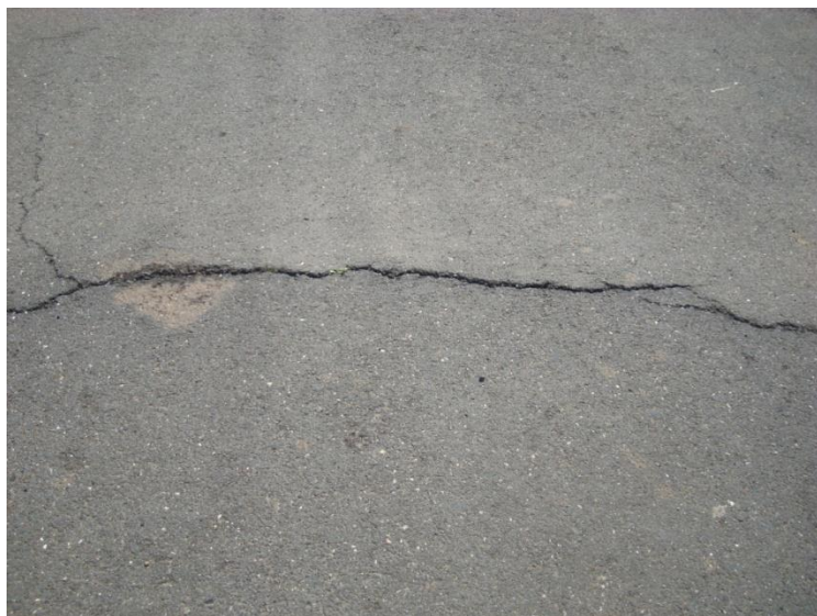
PHOTO 4. FISSURE SUR LA ROUTE MENANT AU PHARE. BELKACEMI 2017
