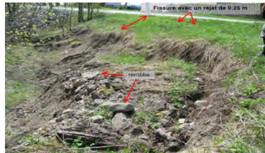
Fig. 2. Déformations du talus au 7 mai 2008.
