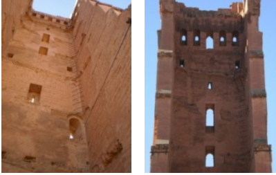
Fig. 52 : Rampes du minaret en ruine de Mansourah/ Tlemcen
