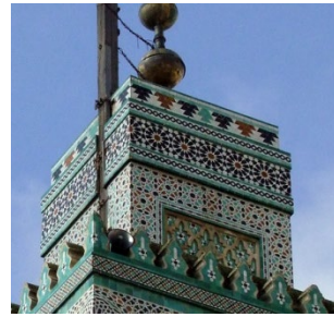
Figure 34: Décrochement au niveau du lanternon, M11
