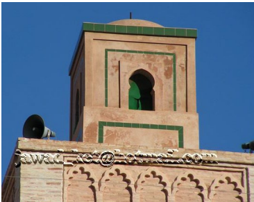
Figure 33: Décrochement au niveau du lanternon, M10
