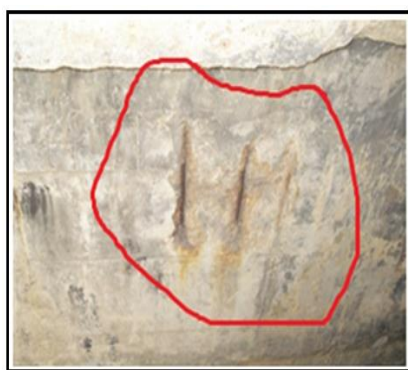
Figure 1. Éclatement du béton d'enrobage de la galerie de Touggourt- Ouargla.
