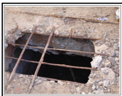
Figure 2. Corrosion des armatures des regards sous l'effet de la carbonatation
