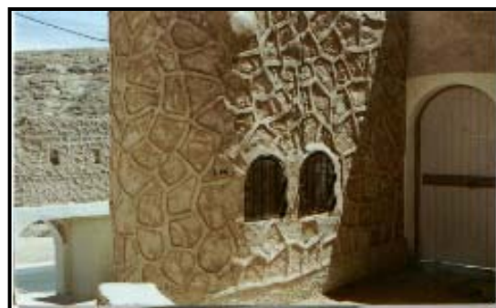
Fig.19 - Mur extérieur sans crépissage
