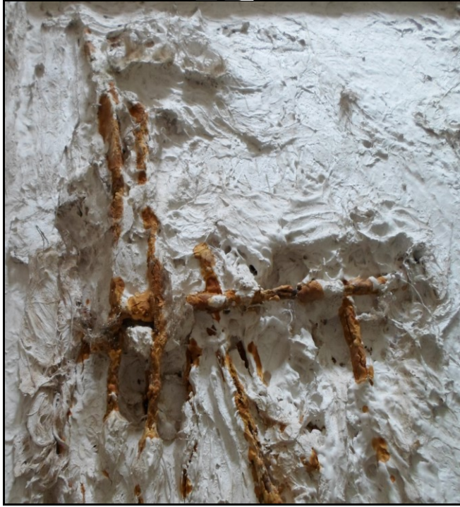
الصورة رقم(05): توضح سوء الترميم باستعمال قضبان حديدية.
