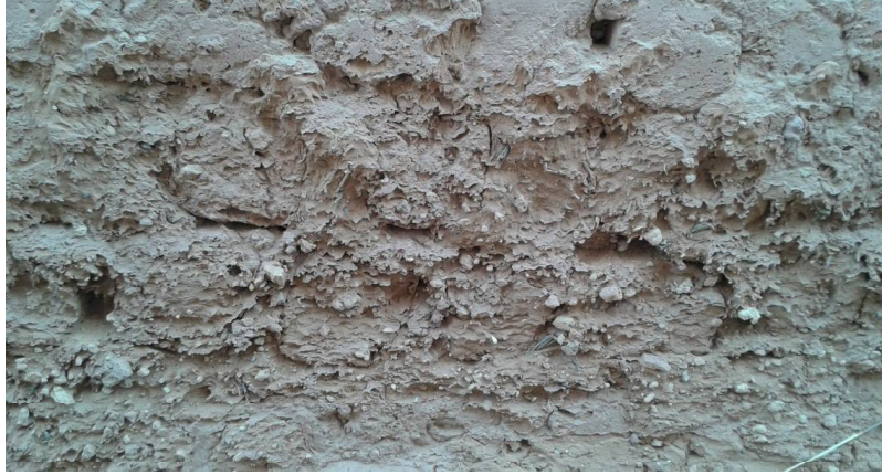
الصورة رقم (2): تبين ظاهرة التآكل تفيتت المواد الأصلية لمكونات البناء تحت تأثير الحرارة
