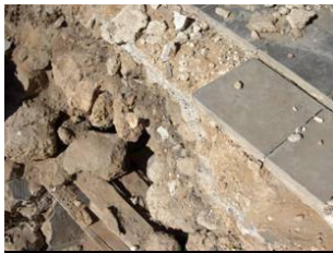
شكل (14): يوضح الأضرار ببيت ظريفة
