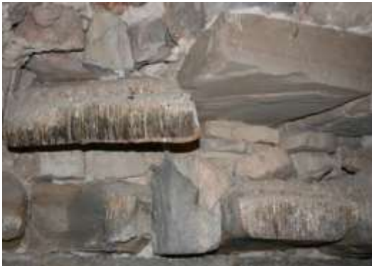
الصورة رقم 06: حالة سقف مدخل المعلم
