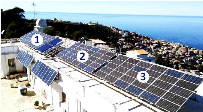
Fig. 2: Générateur PV sur la terrasse de l'Administration du CDER
