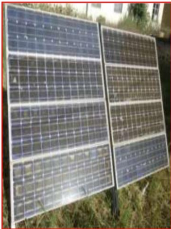
Fig. 2: UDTS photovoltaic panels
