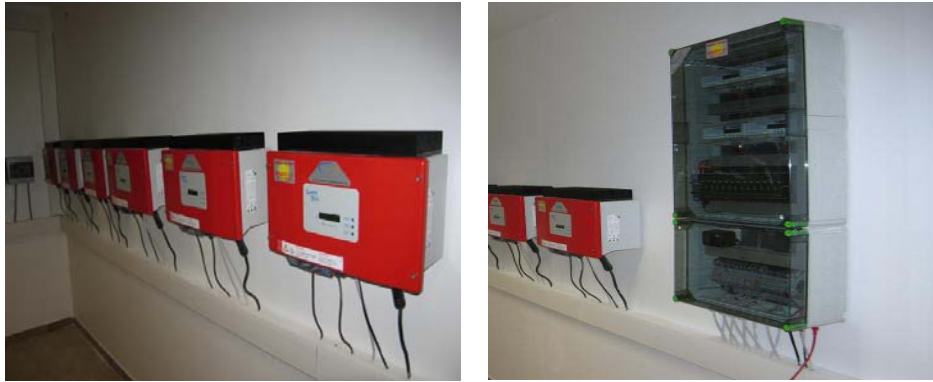
c- Onduleurs connectés réseau
