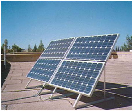
Fig. 2: Panneaux photovoltaïques SP75 installés à la Faculté des Sciences d'Oujda
