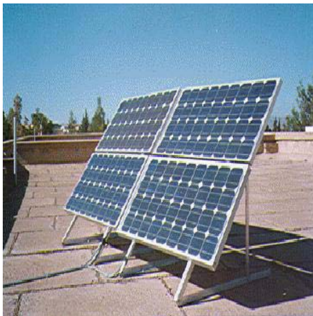
Fig. 6: Panneaux photovoltaïques SP75 installés à la Faculté des Sciences d'Oujda
