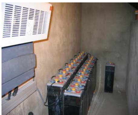
Fig. 5: Vue des batteries de stockage à l'intérieur de l'abri technique
