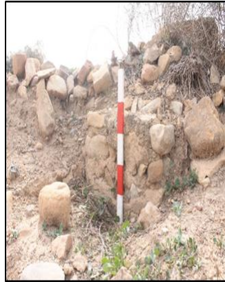
الصورة 06: تظهر وجود الملاط
