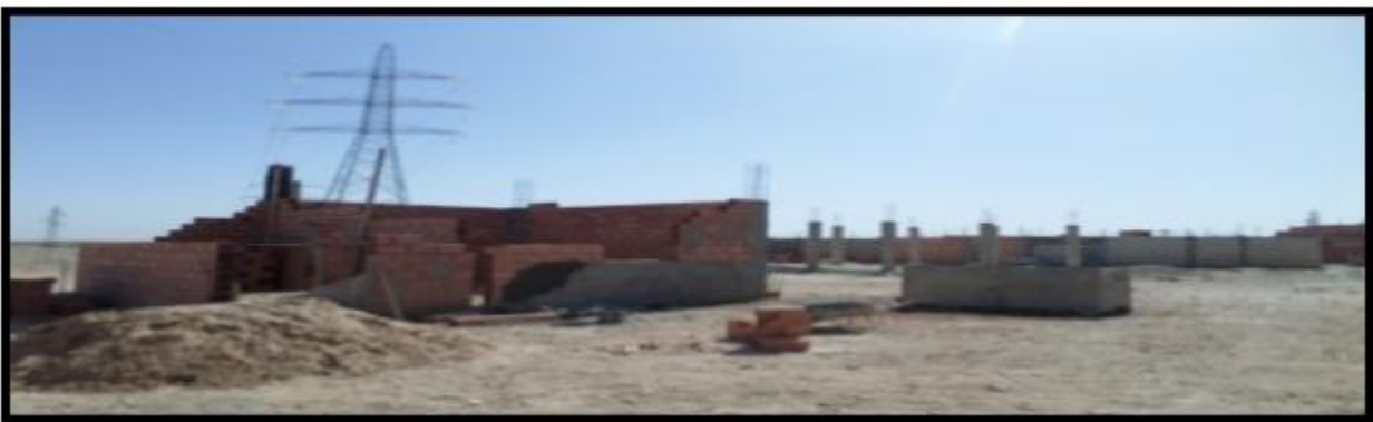
Photo N°(03) ; La présence de travaux de construction représentée dans la construction de colonnes en béton avec des murs extérieurs construction chaotiques sous des fils électriques à haute pression, et lorsque nous avons contacté le propriétaire des travaux, il a refusé de nous répondre et d'arrêter les travaux. Poursuite de la construction de nombreuses habitations, terrasses et murs chaotiques, accomplie par des inconnus. Cité OULADE APAIDALLAH.
