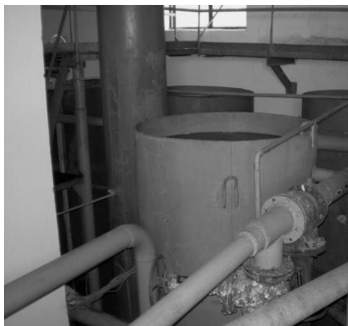
Fig. 2. Station de déferrisation d'eau avec des filtres des billes de polystyrène expansé
