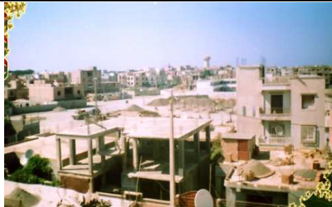
الصورة رقم: 5 البناء الفوضوي بحي علي صادق ببلدية برج الكيفان التقطت بتاريخ 2011/08/12
