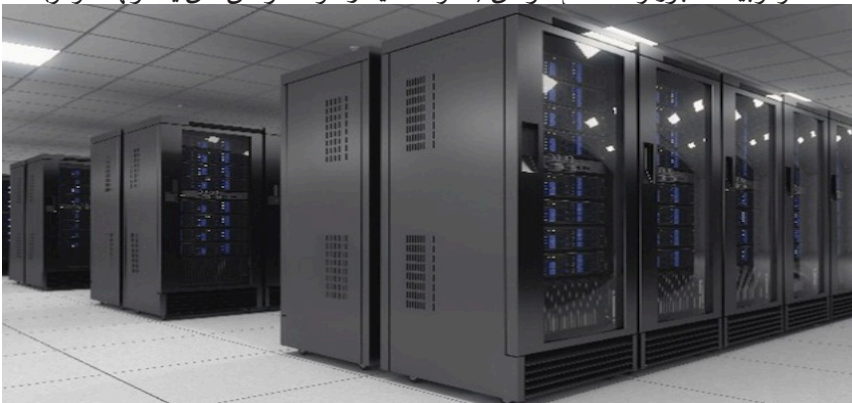
الشكل-03- مركز البيانات Data Center
