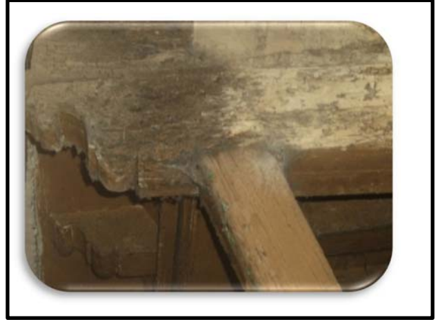
صورة 01 رطوبة على الجدران وفي الأخشاب نتيجة تسرب مياه الأمطار أو مياه الرش مع حدوث انتفاخ وتمدد في أبعاد الخشب عن الطالب
