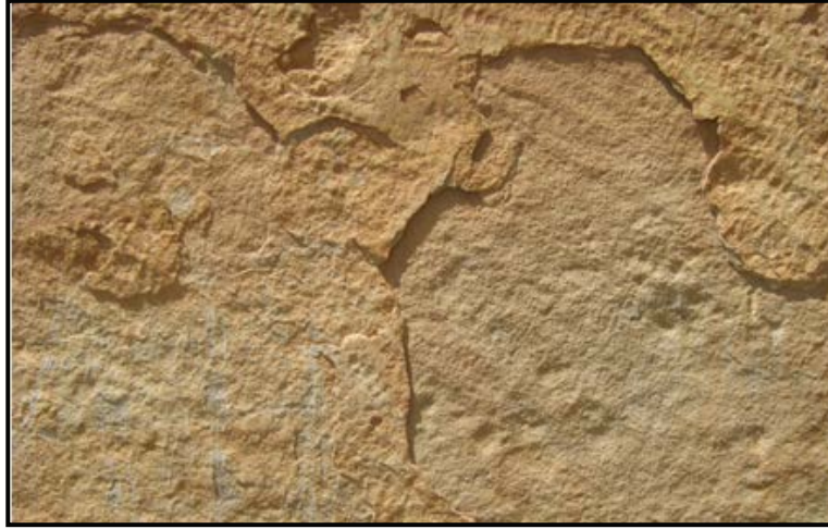
الصورة رقم 1: انفصال لطبقة رقيقة من حجارة كلسية موقع خميسة بسوق اهراس
