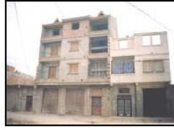
صورة رقم (14): - عدم كجائن الواجهات بسبب عدم التوافق في الارتفاع - مسكن جاهز ومسكن غير جاهز
