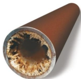
Figure 2. Phénomène d'entartrage à l'intérieur des conduites.
