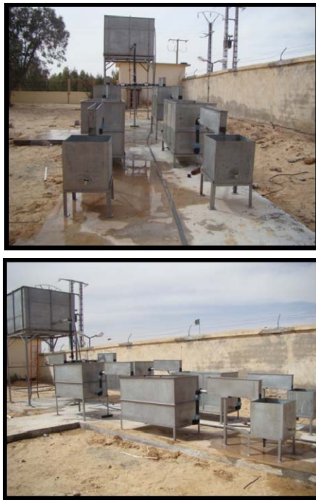
Figure 03 : photos réelles de la station pilote implanté à Touggourt.
